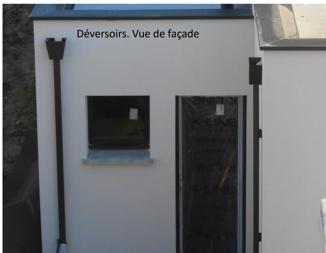
Figure 27 : Traitement des eaux pluviales
