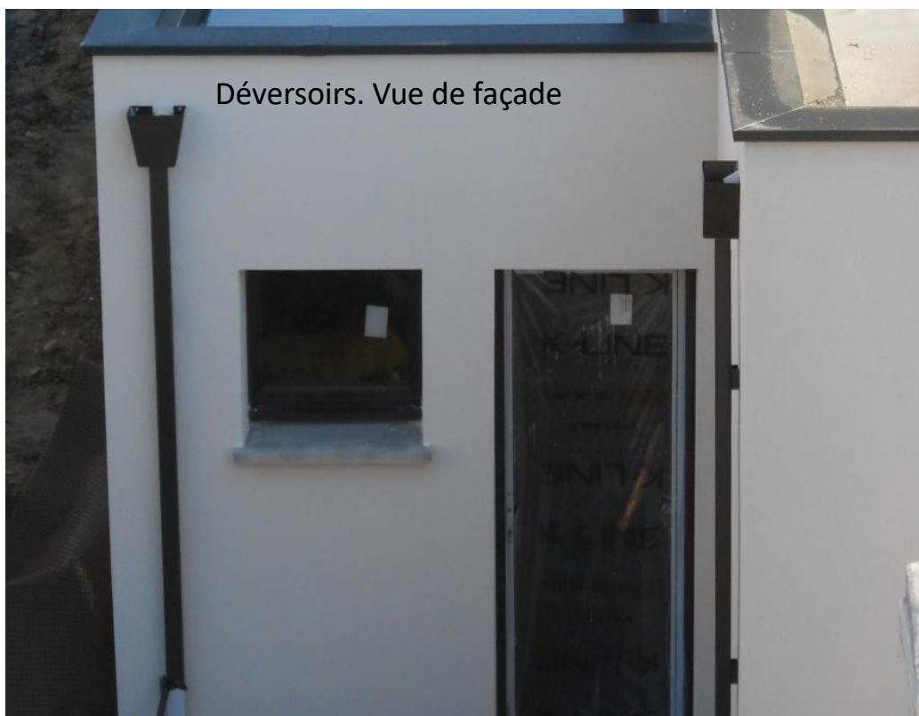
Figure 27 : Traitement des eaux pluviales
