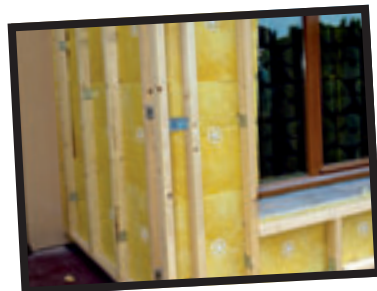
Après perçage des murs au travers de l'isolant, des chevilles «toiles» frappées maintiennent l'isolant. Les montants de l'ossature bois sont ensuite vissés sur le cran des querres.
